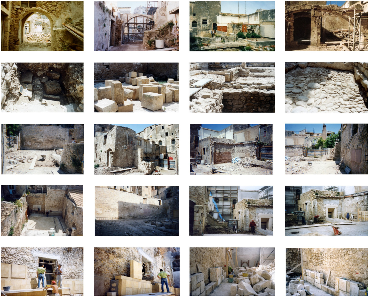
Fig. 4 - Foto di alcune fasi lavorative del cantiere. Sources: courtesy of Vincenzo Latina.
