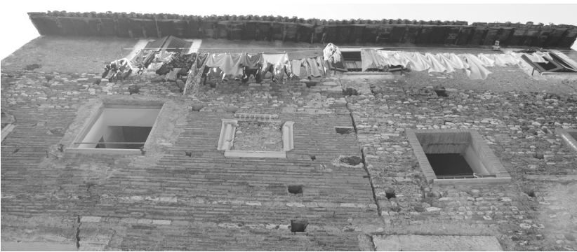
Fig. 15 - Wall discontinuities in via di Postera.
